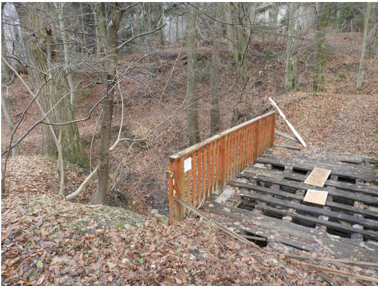
A híd tönkrement korlátpalánkja.
